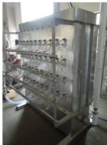
図4 廃蒸気発電システムの外観
