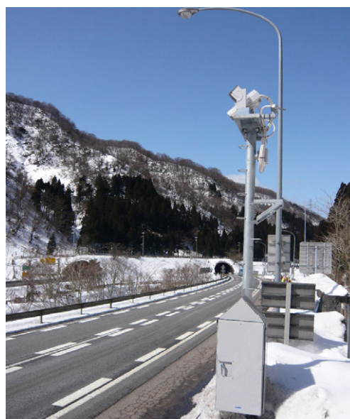
図4 北陸自動車道に設置された降雪路面監視装置
